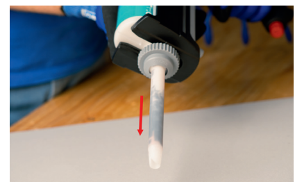
Vullen van de statische menger met lijm. Homogeniteit van het mengsel controleren (zie verwerking begeleidende kwaliteitscontroles 2K-producten)
